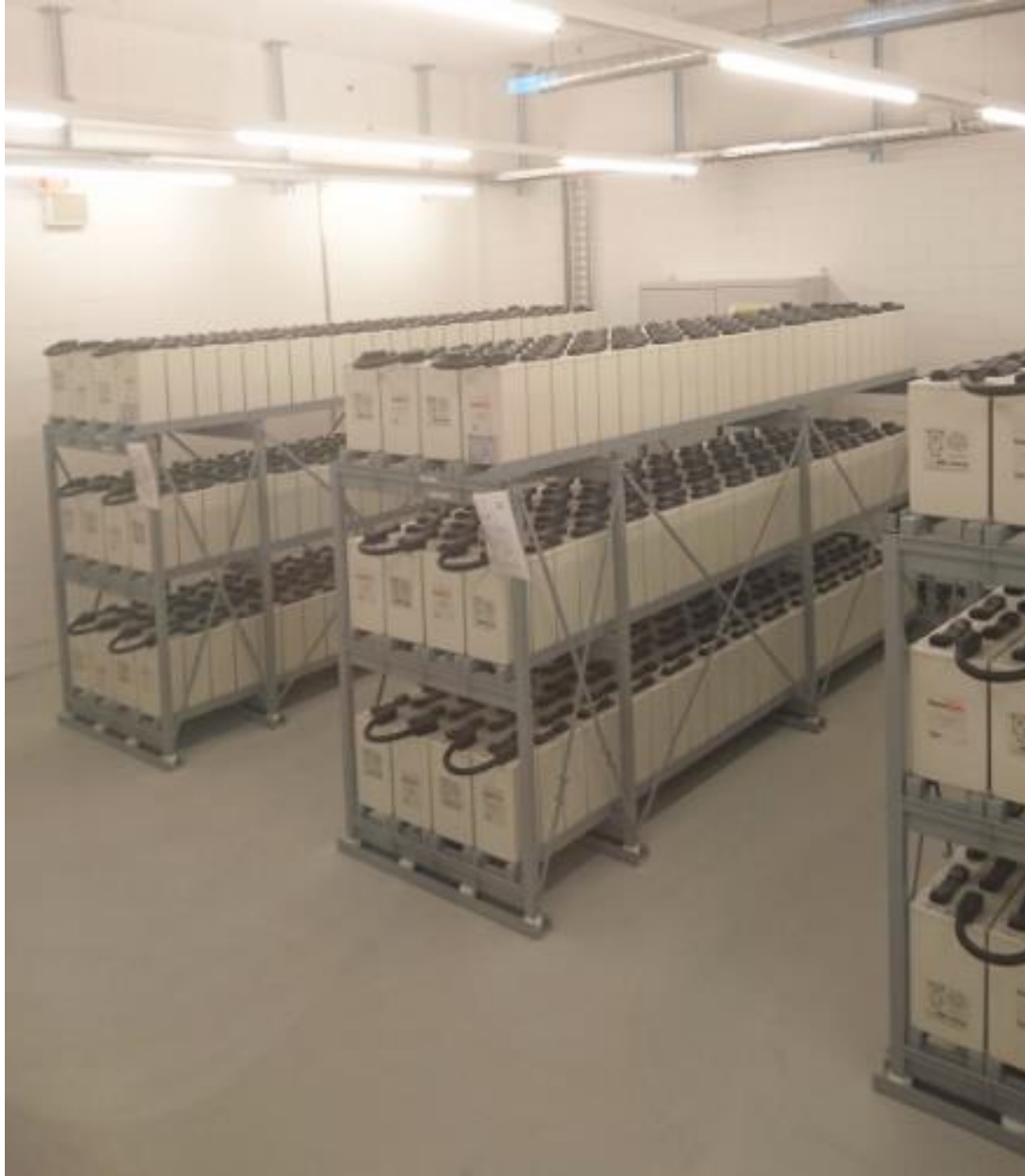
Stützbatterien für Stromausfall
